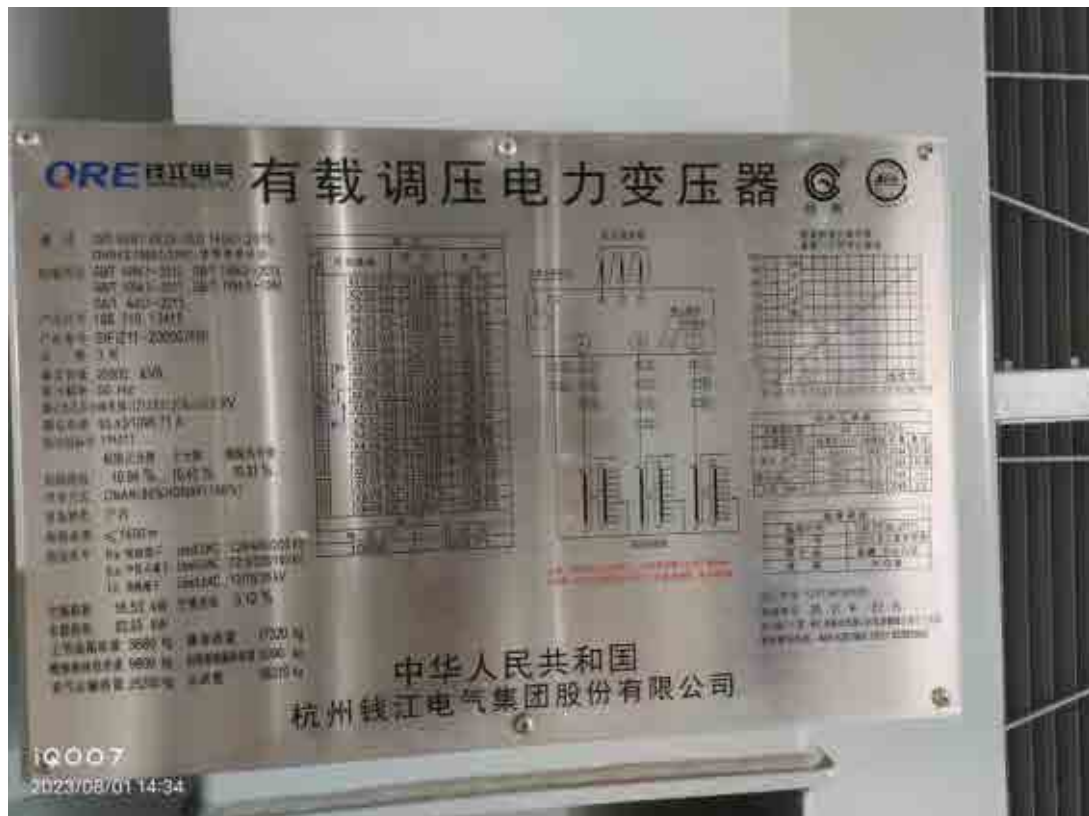
图4-4 项目升压站主变设备铭牌
