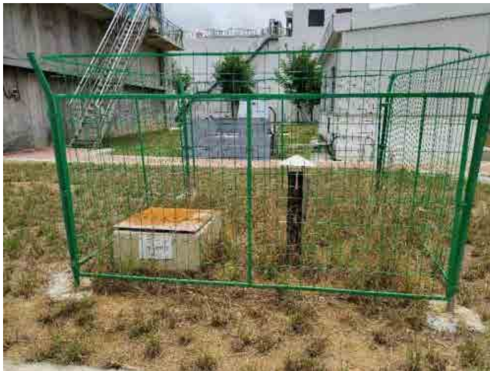
图 4-6 项目升压站箱变事故油池
