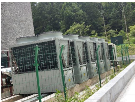
中央空调机组
