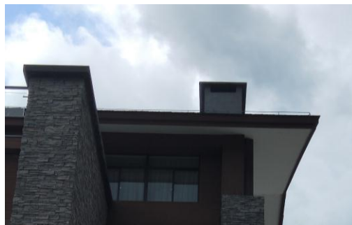
厨房油烟排气口
