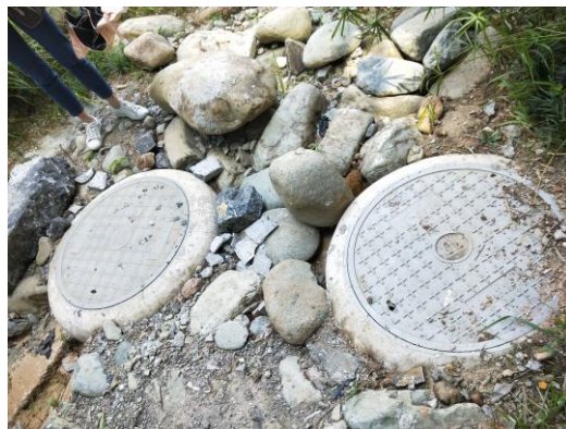
西餐厅隔油池
