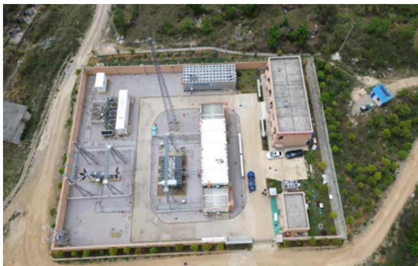
升压站全景照片
