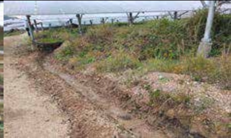
光伏阵列区已实施的临时排水沟
