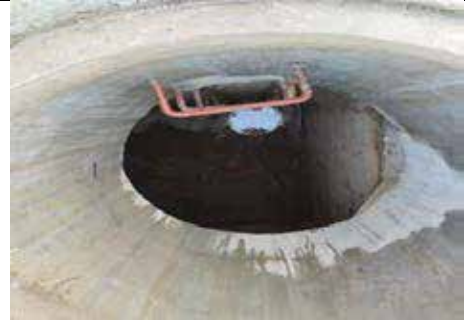
事故油池照片 2
