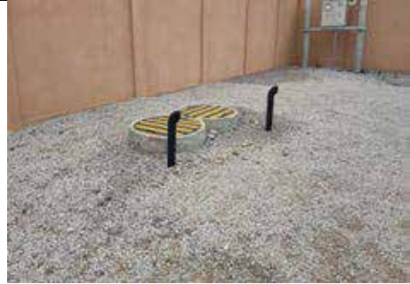
事故油池照片 1
