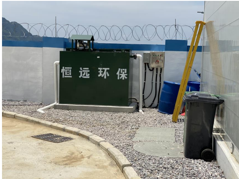
生活污水处理设施
