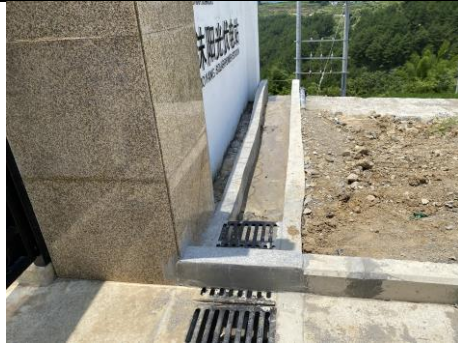
升压站截排水沟
