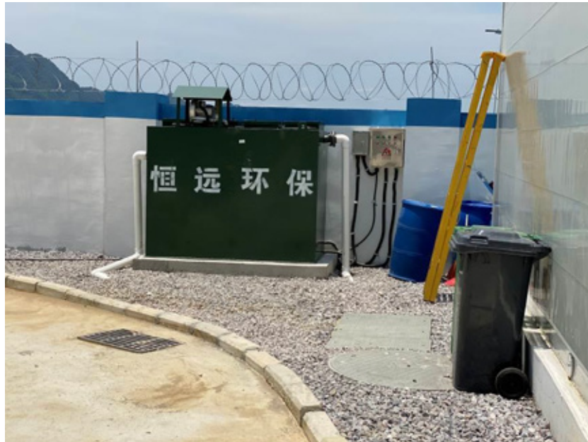
生活污水处理设施
