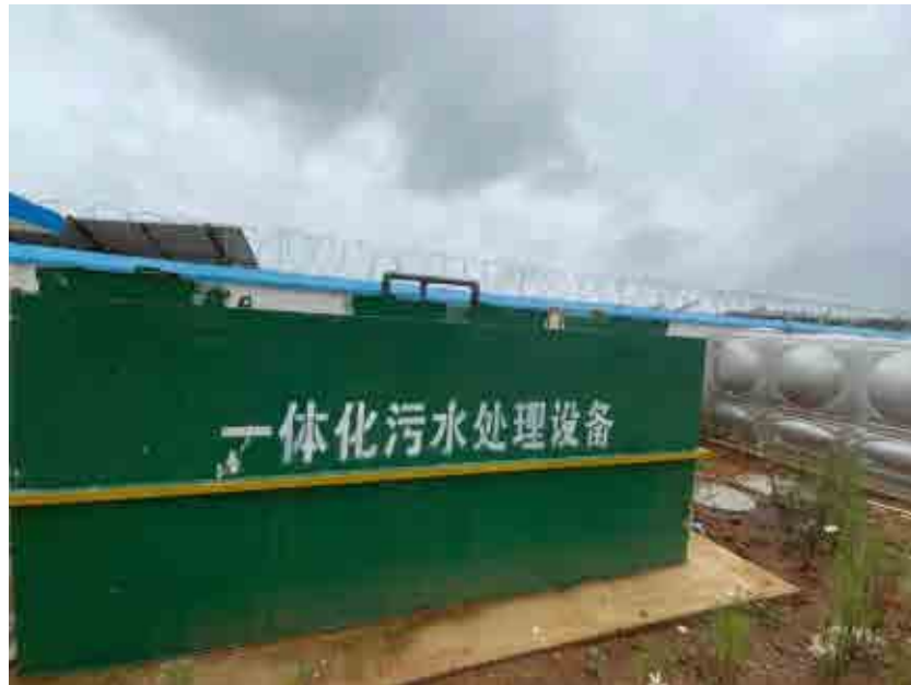
生活污水处理设施
