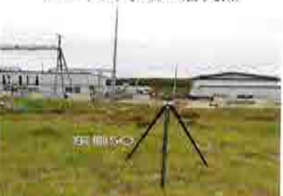
N8# 升压站衰减断面东侧 50m 处
