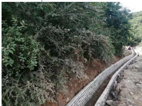
场内道路排水沟
