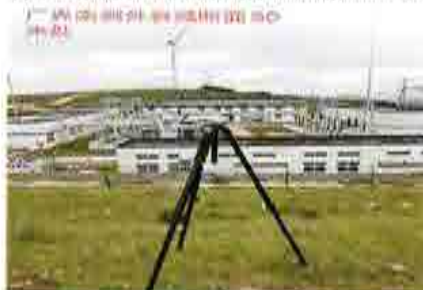
N13#升压站衰减断面南侧 50m 处 (昼)
