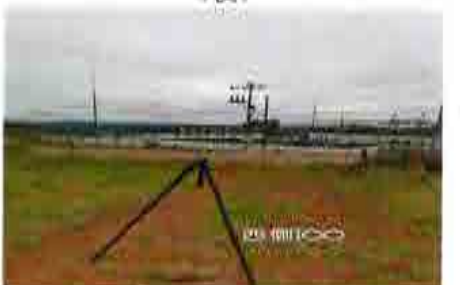
N19# 升压站衰减断面西侧 100m 处
