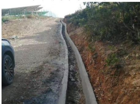
场内道路排水沟
