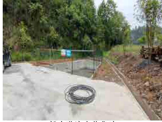
场内淋溶水收集池
