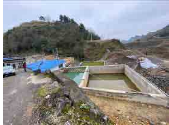
矿井水处理站
