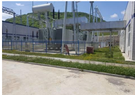
升压站内绿化
