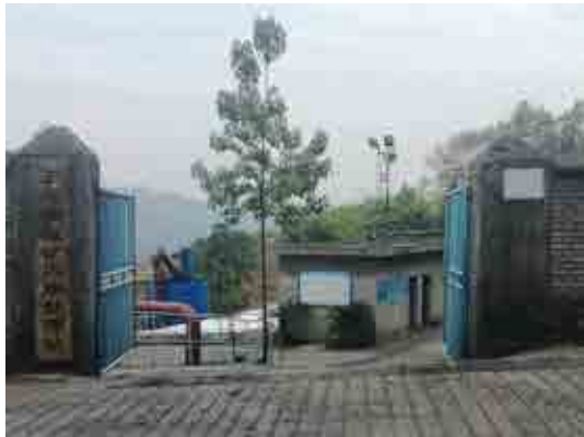
污废水处理站
