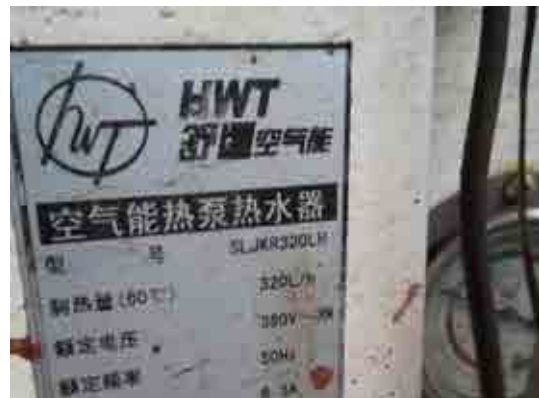
空气能供热机组
