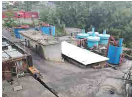
矿井水处理站
