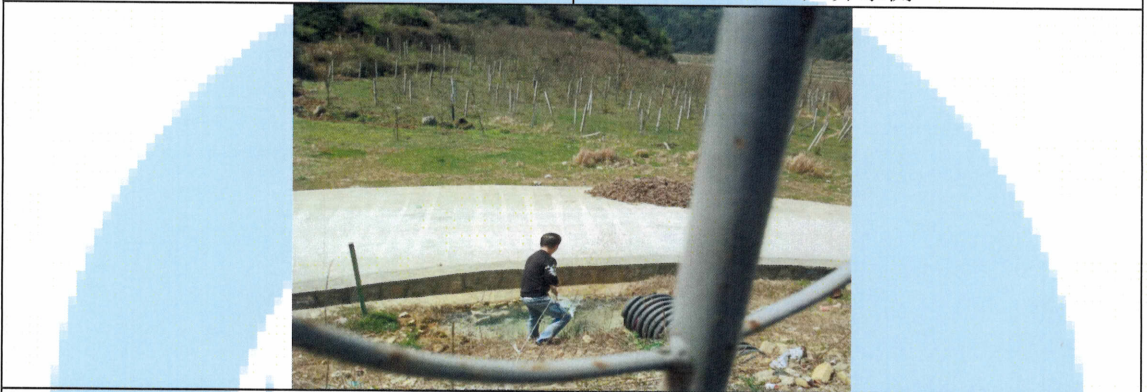
污水处理设施出口
