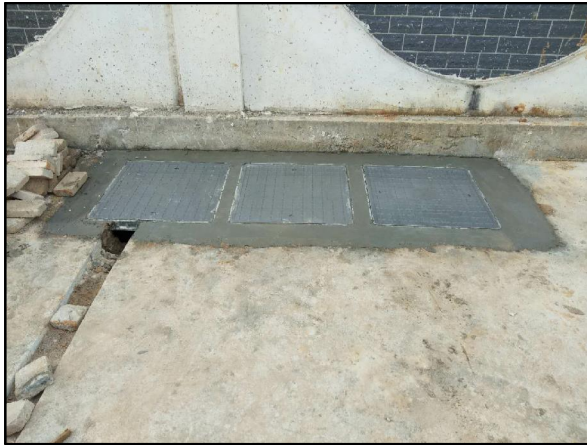
沉淀池、隔油池
