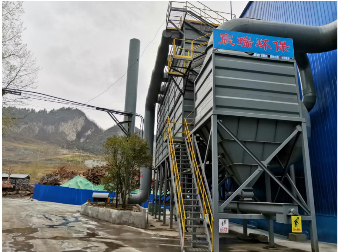
除尘器及排气筒
